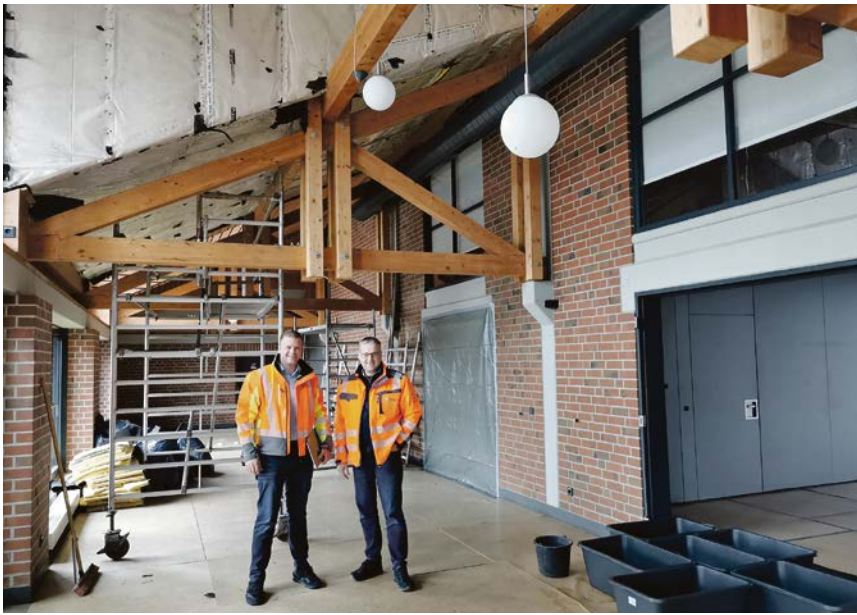
v.l.: Fabian Schulte im Busch und Bauhofleiter Markus Freck haben seitens der Stadt Olfen die Bauleitung für die Brandsanierung der Stadthalle übernommen.
