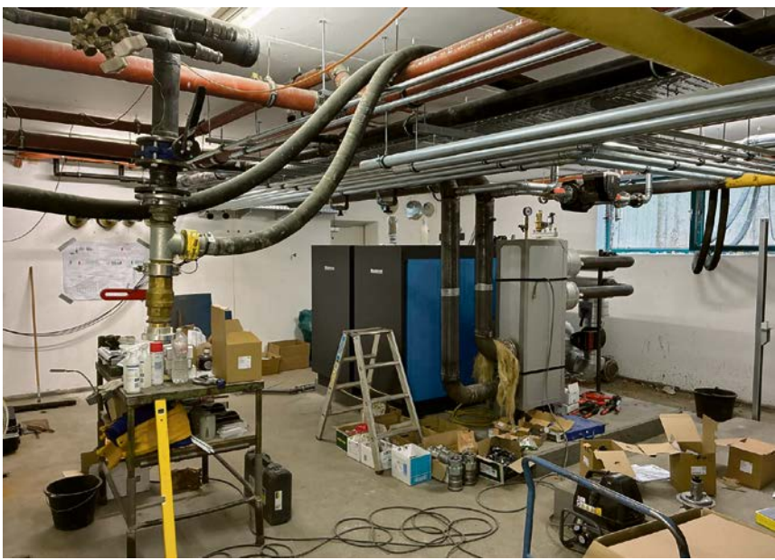
Das Foto zeigt die zwei je 500 KW Brennwertkessel der neuen Heizungsanlage. Das neue Blockheizkraftwerk (BHKW) ist am 10. August in den frisch sanierten Heizungskeller eingezogen. Foto: Stadt Olfen
